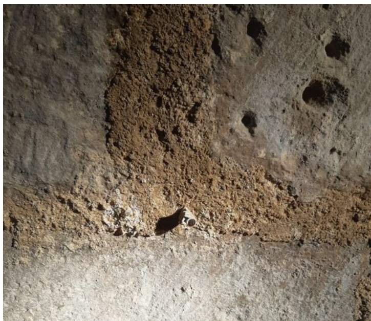
Mur de l'église Saint-Savinien © Photo : Marion Robin
